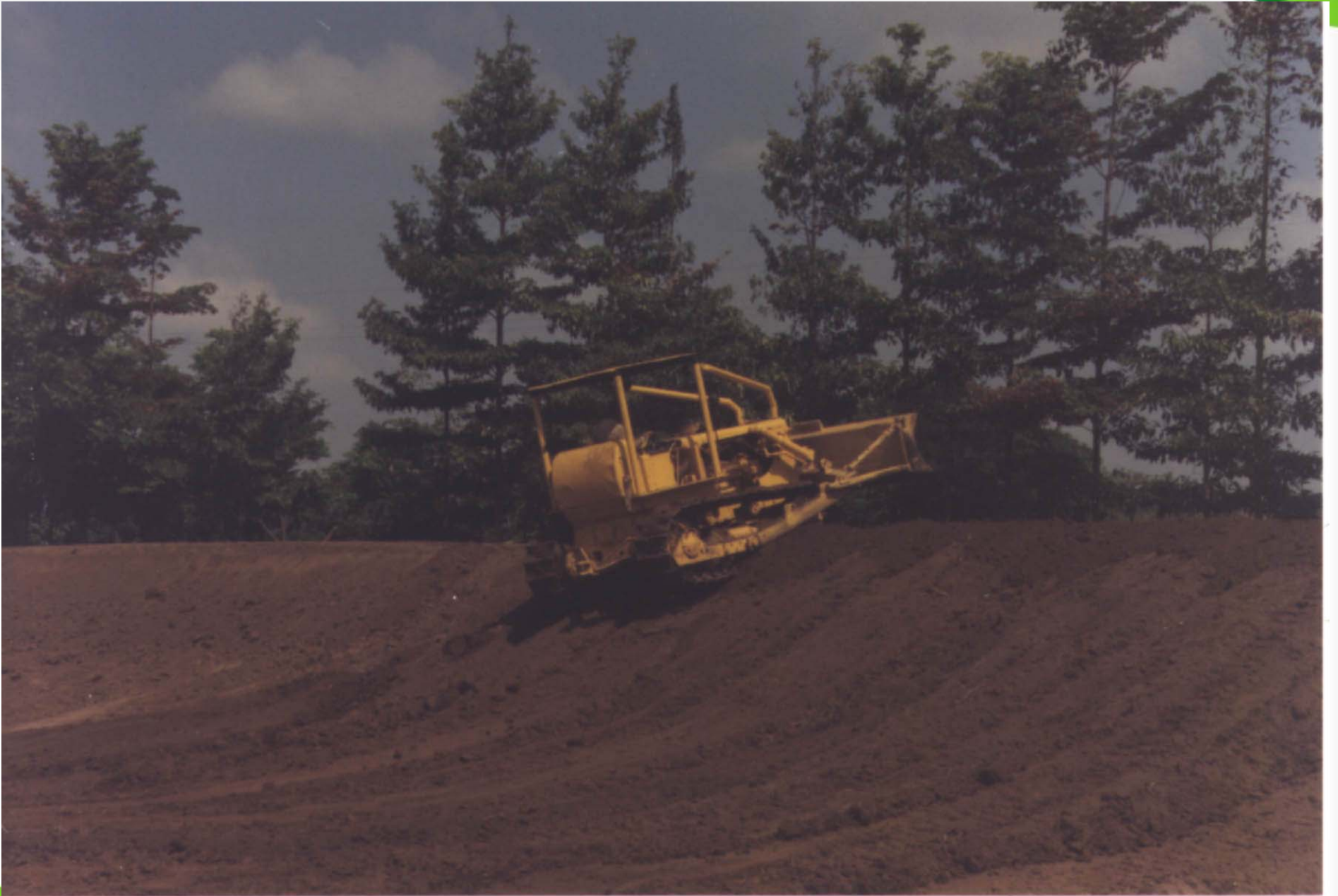
Construcción del terraplen para la vía entre Juana Sanchez y Hatillo de Loba (Isla de Mompox).
