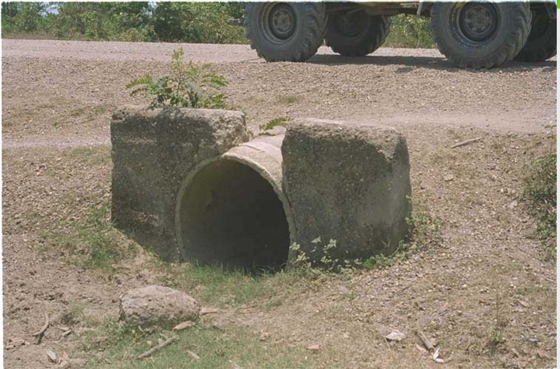
Estructura ineficiente para drenaje, terraplen de la vía Mompox - Hatillo de Loba (Isla de Mompox).
