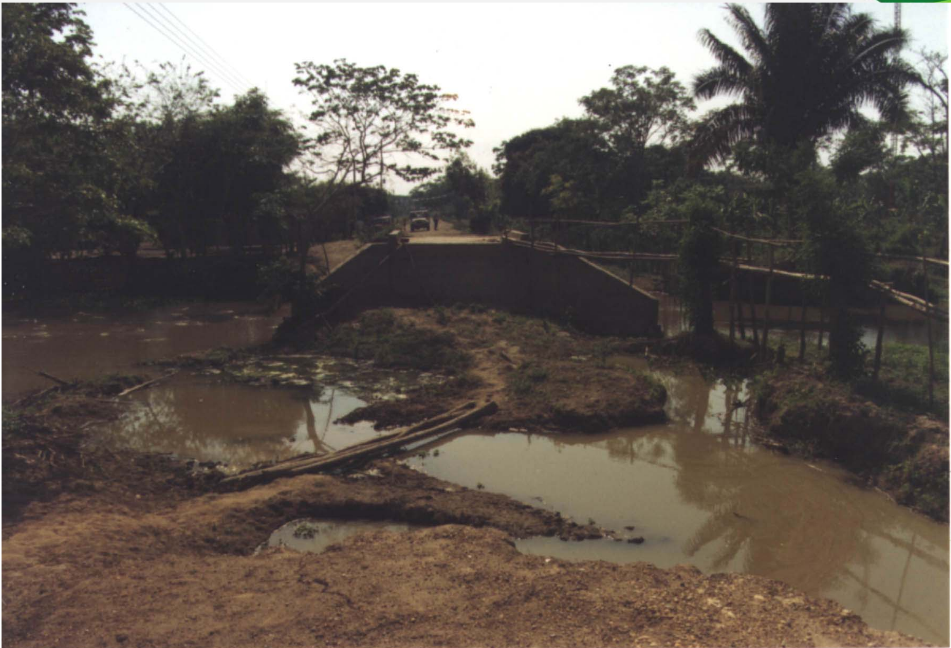
Deterioro de la vía por interferencia del drenaje e ineficientes estructuras, sector Margarita (Isla de Mompox).
