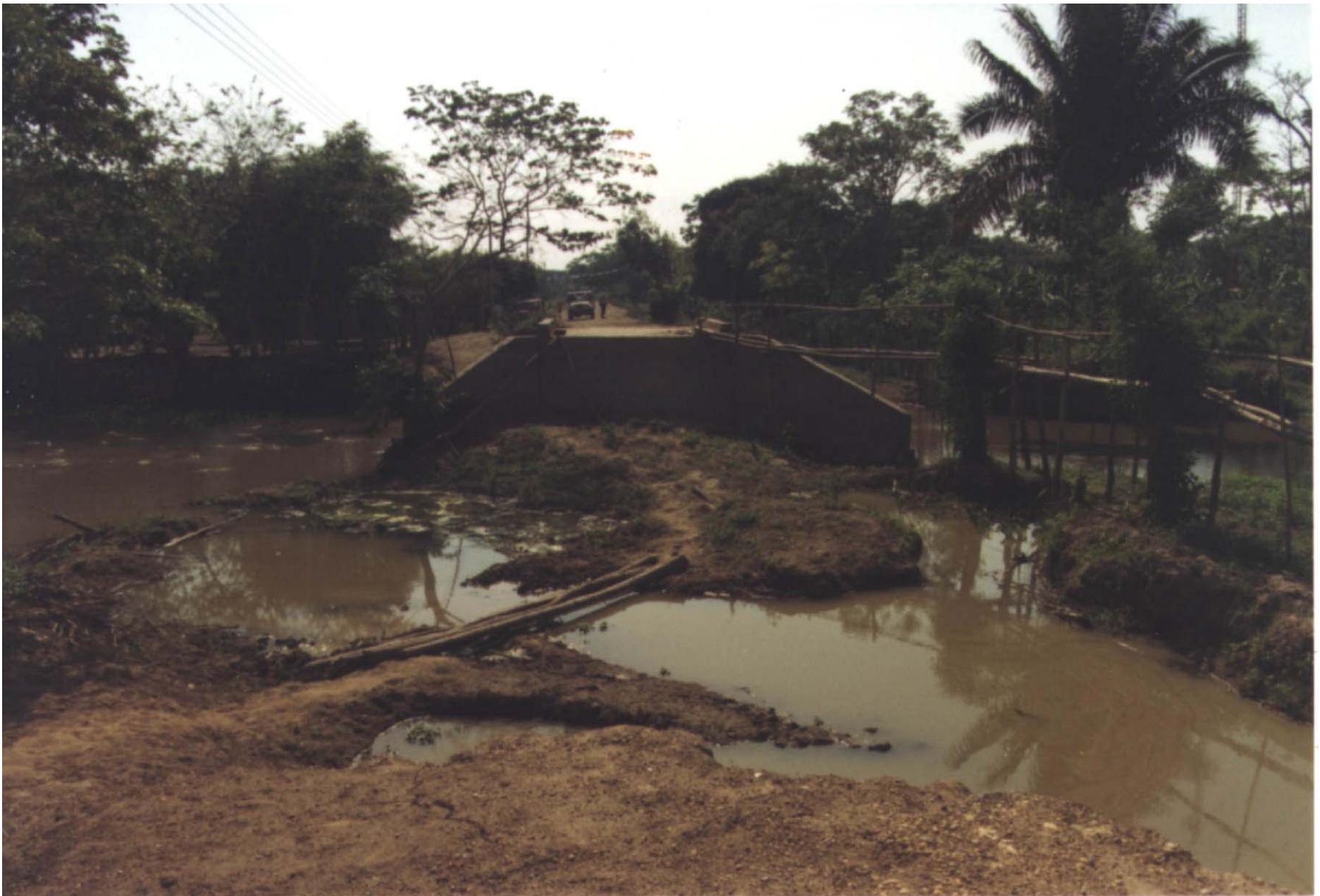
Deterioro de la vía por interferencia del drenaje e ineficientes estructuras, sector Margarita (Isla de Mompox).
