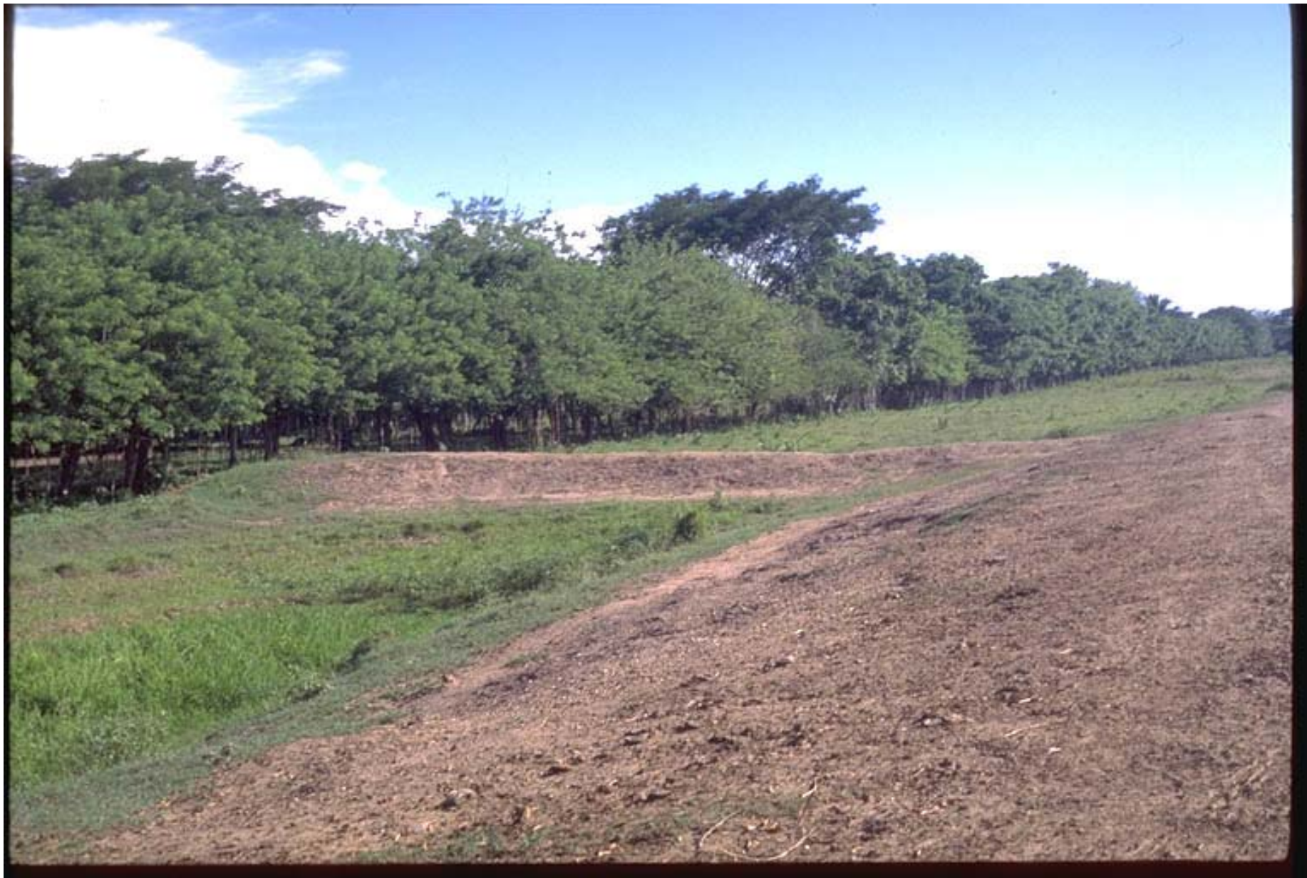
Construcción de diques y terraplenes, alrededores del caño La Puente, Isla de Mompox.
